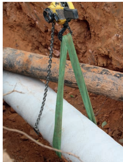
Die alte und die neue Leitung: Durch die turnusmäßige Sanierung erhöht sich nun die Transportkapazität des Abschnitts.
