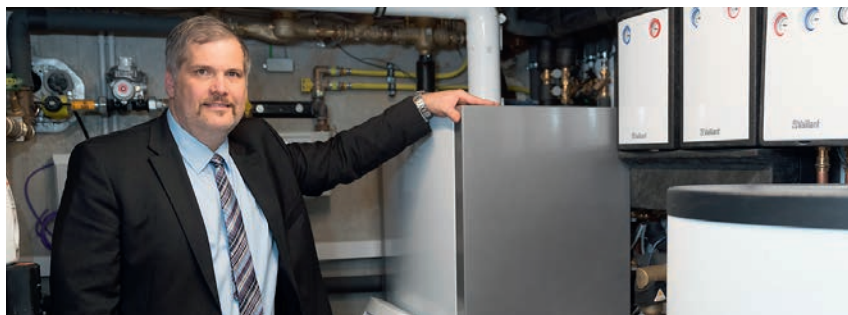
Michael Zanner, Geschäftsführer eines IT-Beratungsunternehmens aus Nidderau, hat sich für eine Zeolith-Heizanlage entschieden und heizt nun besonders effizient und umweltschonend.
